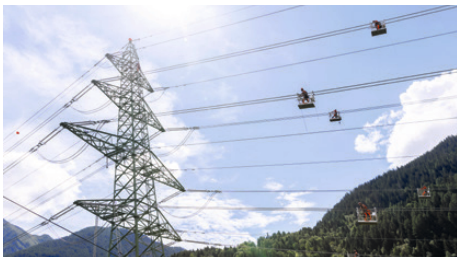
Bei dieser Bauetappe wurden die Abstandshalter unter spektakulärem Einsatz der Freileitungsmonteure montiert. Diese sorgen dafür, dass die Leiterseile bei Wind nicht aneinander schlagen.
